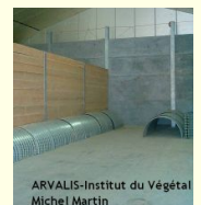
Stockage ventilé en vrac
